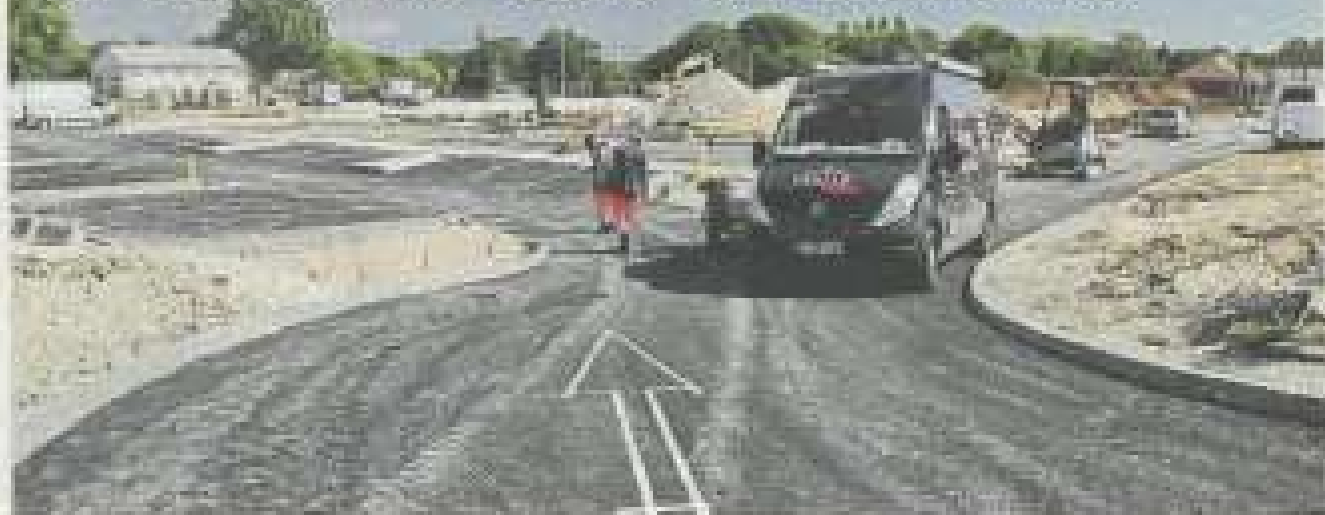
Devant le chantier, au fond s'élevés le bâtiment abritant les nouveaux locaux.
