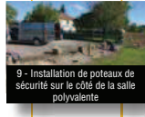
9 - Installation de poteaux de sécurité sur le côté de la salle polyvalente
